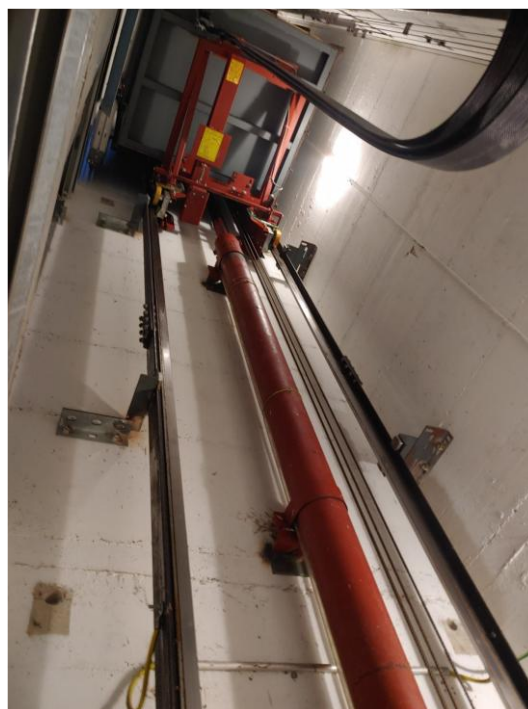
Liftschacht mit Kabine
